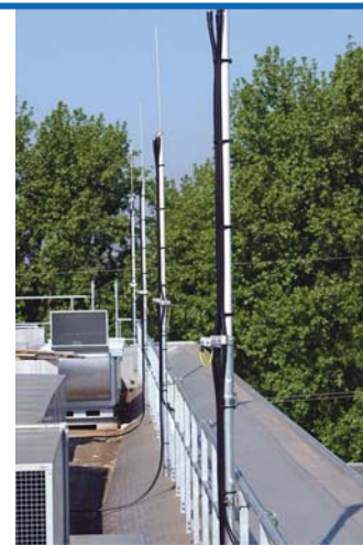
Blitzschutz für klimatechnische Dachaufbauten
