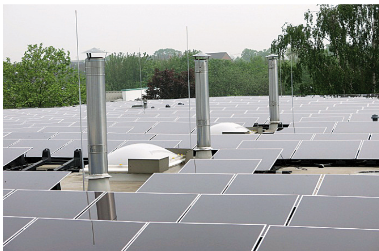
Bild 5 Fehlerhafter Schutz: Durch die zu geringe Freifläche kann der Trennungsabstand nicht eingehalten werden.
