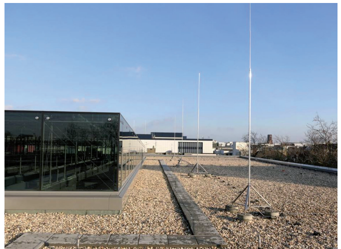
Bild 11 Fangeinrichtungen zum Schutz einer Glasüberdachung.
